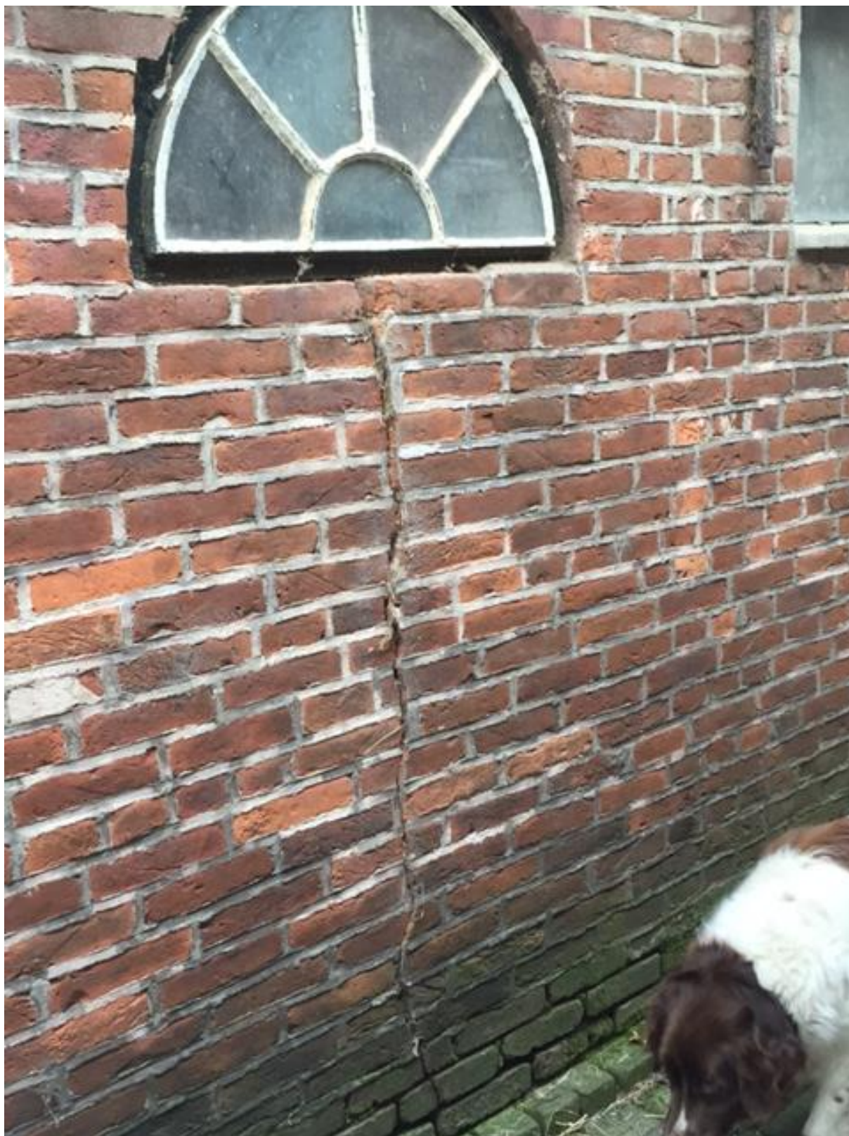
Scheur gevel karnschuur
