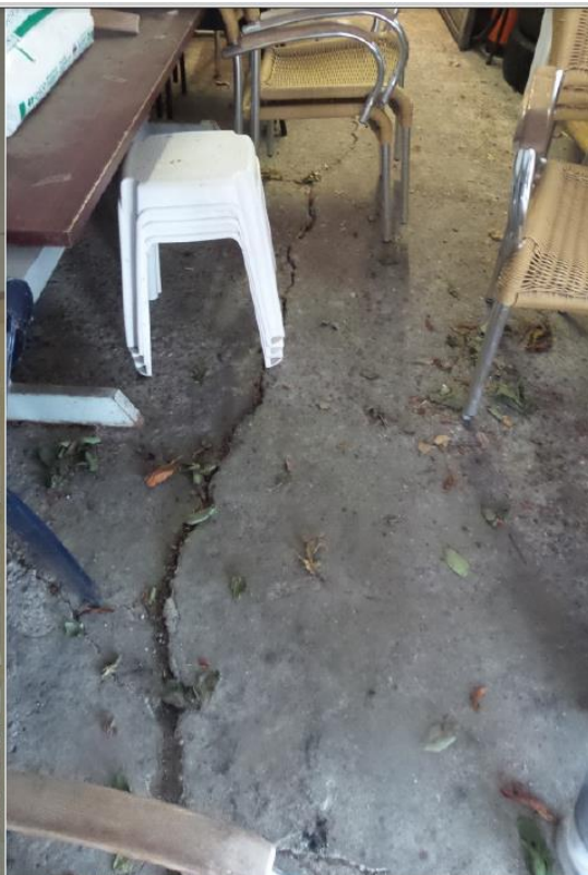
Figuur A8: Verzakte vloer in schuur
