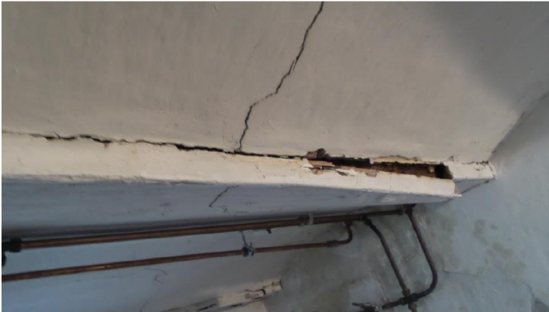
Figuur A5: Scheurvorming in de kaaskelder (begane grond vloer)
