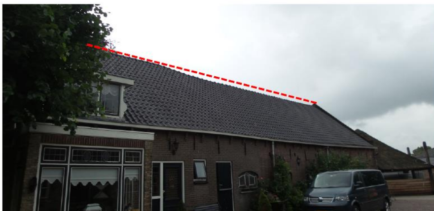
Figuur A2: Verzakkingen van boerderij zichtbaar in het dak
