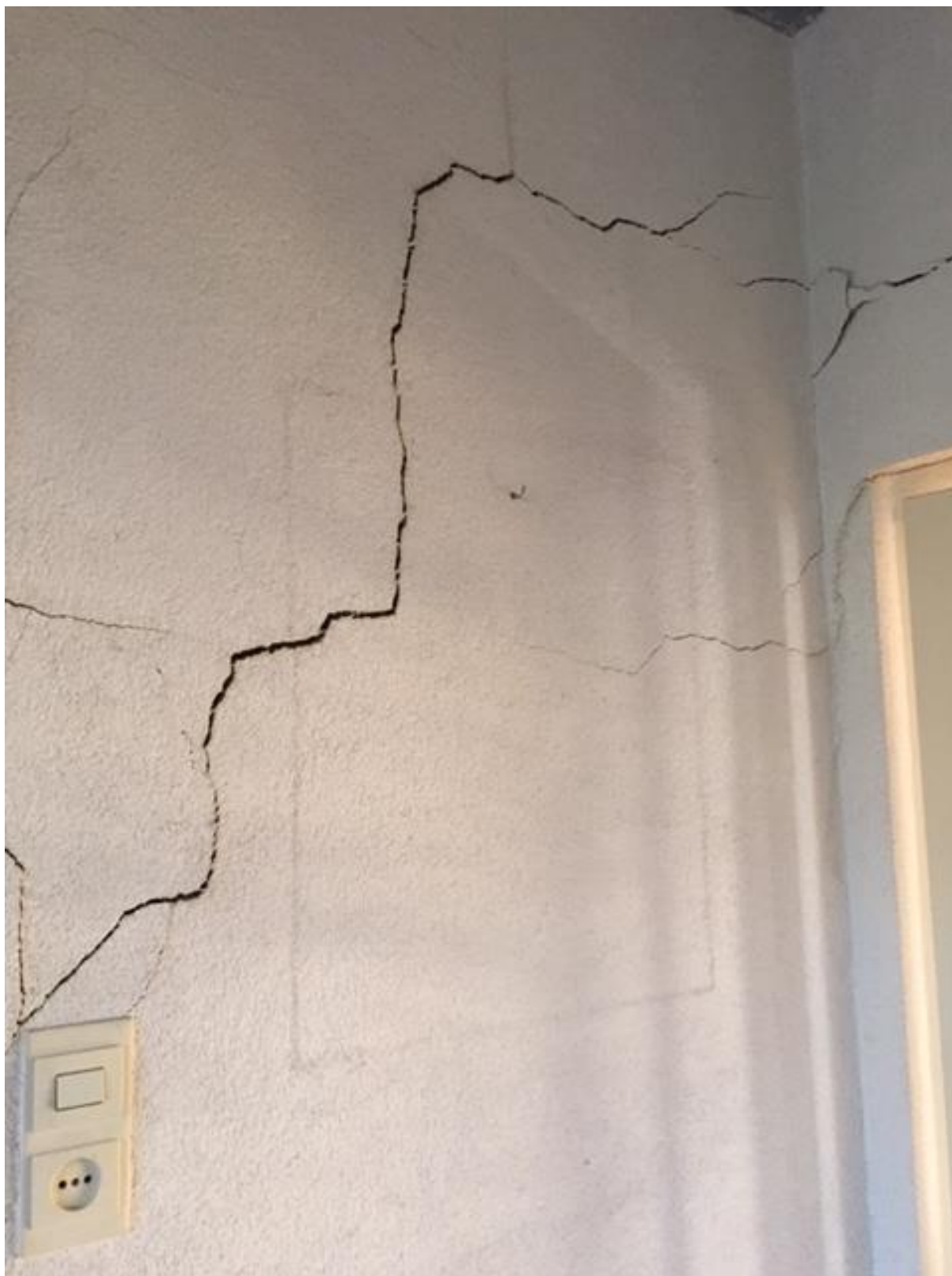
Scheur muur keuken
