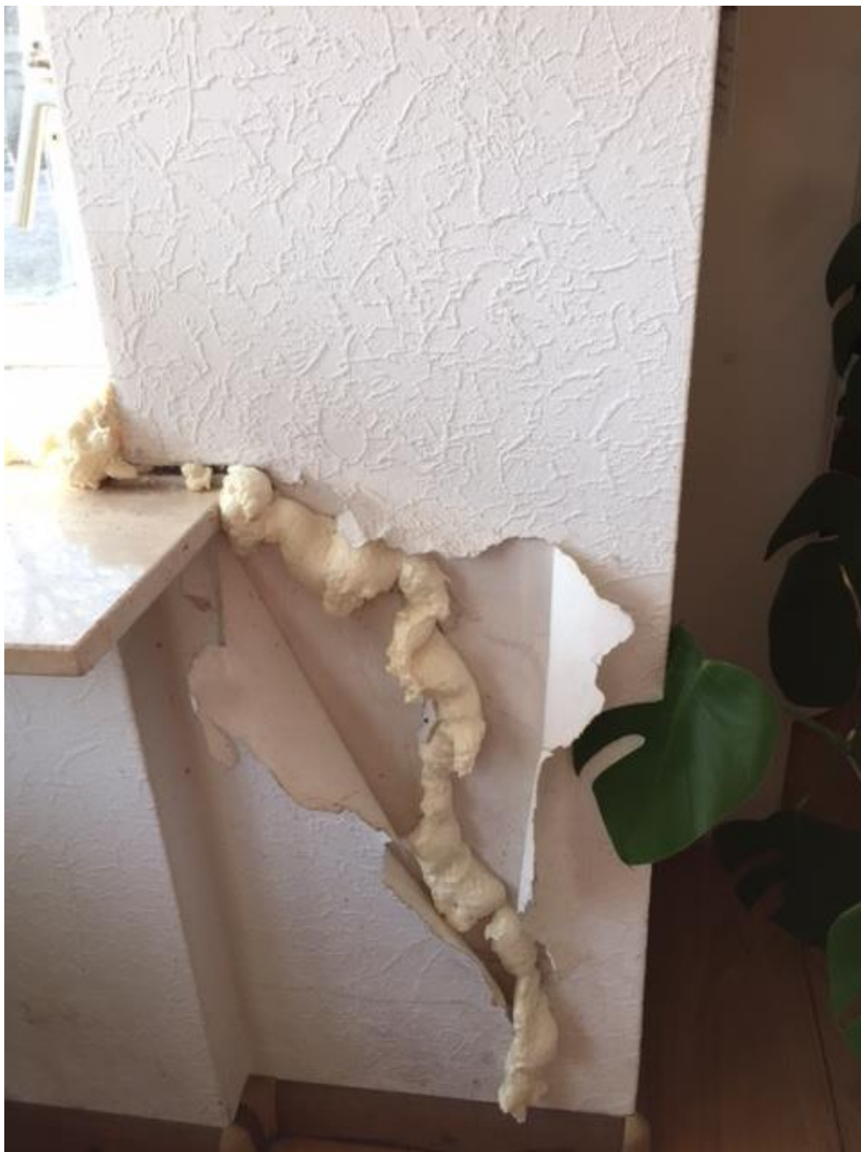
Scheur vensterbank erker
