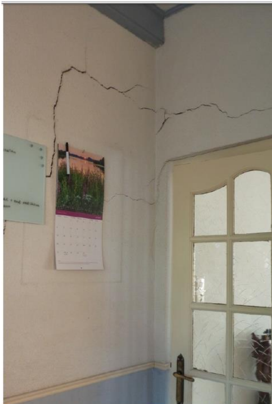
Figuur A7: Scheurvorming in boerderij
