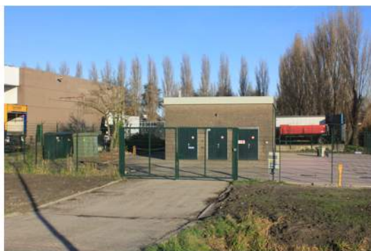
Gasdrukregelstation aan Berkelseweg.
